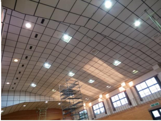
照明LED化で明るくなった大集会室(138号)
